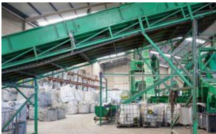
Figura 12: Instalaciones de reciclaje de RAEE en Lobón (Badajoz).
